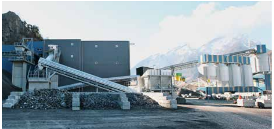
Veredelungsanlage im Werk Rotzloch
